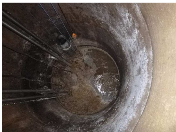
PR Barges - Puits de refoulement
